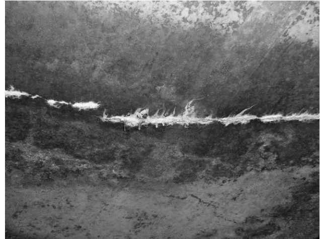
Bild 2: Aussinterungen an einem Deckenriss
