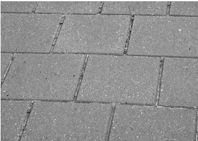
Bild 7: Ausblühungen nach 36 Monaten
