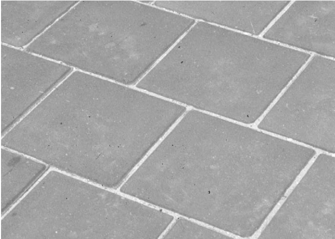
Bild 5: Ausblühungen nach einer Woche
