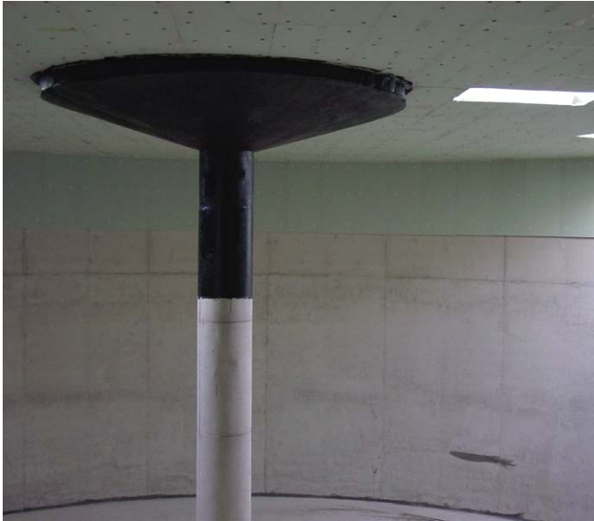
Bild 6: Beschichtung und Wärmedämmung im Fermentergasraum
